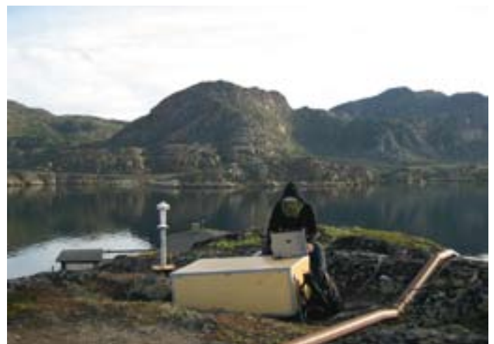
De arktiske forhold stiller helt andre krav til de tekniske installationer – et grundfjeld, som man går på, og hård frost er baggrunden for denne rørføring, hvor vandledningen på fjeldets overside er forsynet med el, så den ikke fryser.
